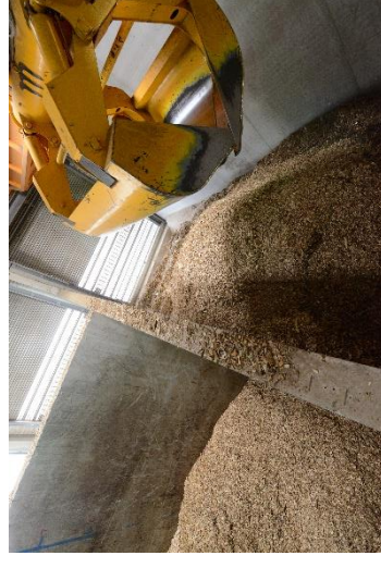
Stockage de combustible à la chaufferie bois d'Epinal
